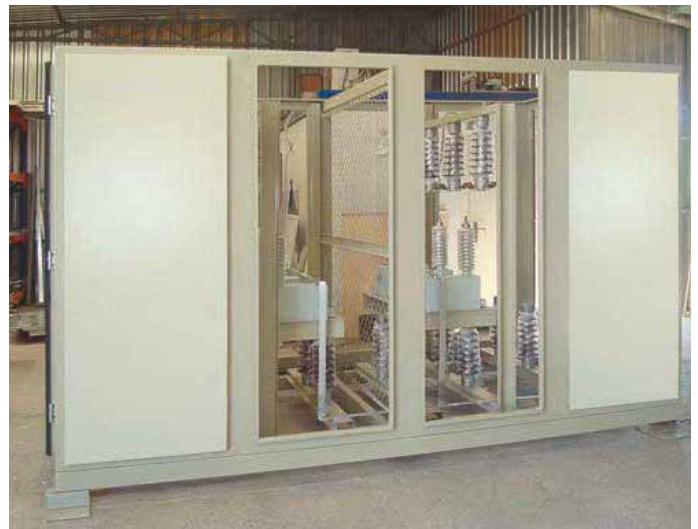
Sac köşk içerisinde uygulama Sheet metal substation application
