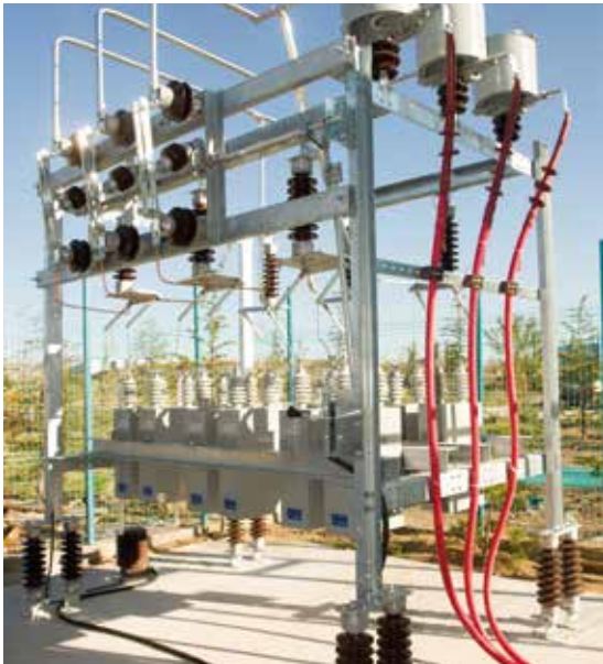
Şalt tipi kapasitör bank yandan görünüm Side view open substation capacitor bank
